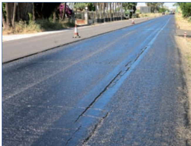
Foto 7. Tramo de prueba, con un pavimento muy fisurado, donde se extendió directamente la mezcla betún-polímero, para ejecutar los ensayos a escala real.
